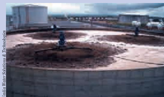
Vue d'une installation de traitement des effluents d'une industrie des biocarburants, mise en service en 2006. Cette installation est couplée d'un traitement anaérobie UASB.
